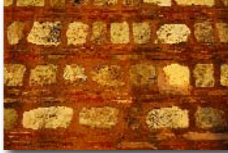
Fotoğraf 2. Duvar dokusu fotoğrafı: Fotoğraf 1'deki duvarın fotoğrafik ışık düşen kısmının duvar detayı.
